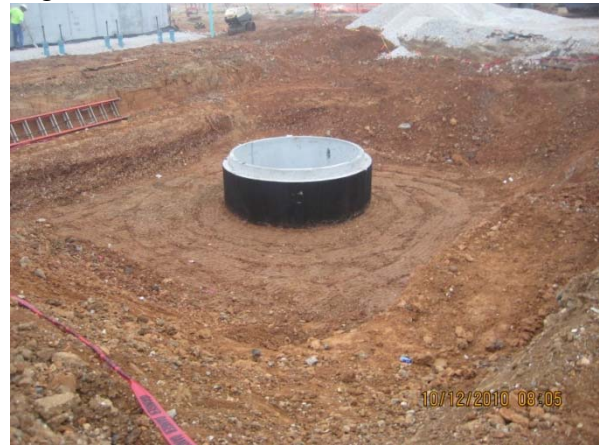
Filter Backwash Pump Sta.
